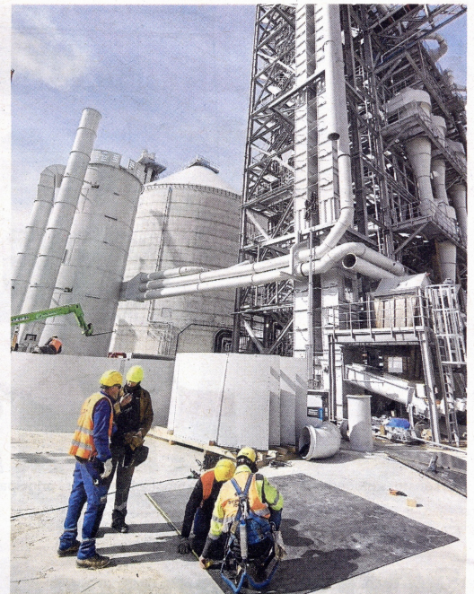
Instal·lacions de Kronospan al Catalunya Sud. FOTO: JOAN REVILLAS
