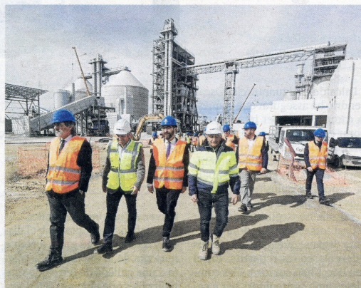
Visita del conseller Juli Fernández a les obres de construcció de Kronospan. FOTO: JOAN REVILLAS
