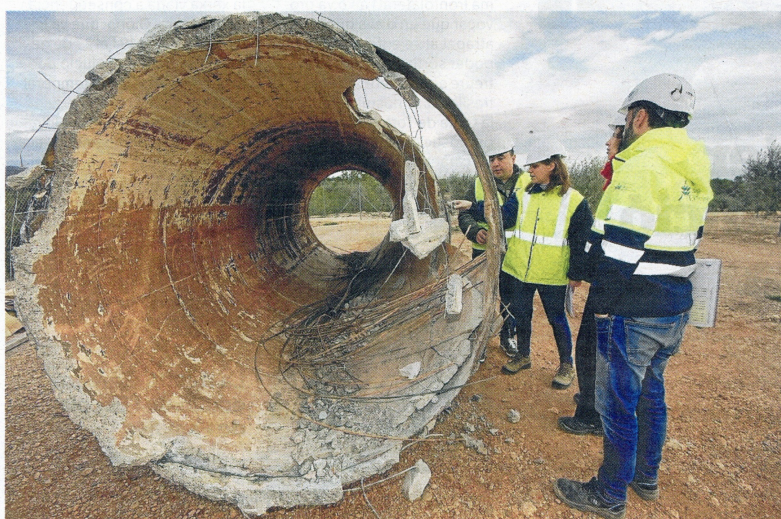
Tècnics del CAT revisant la canonada avariada el 2020 a l'Ampolla. FOTO: JOAN REVILLAS
