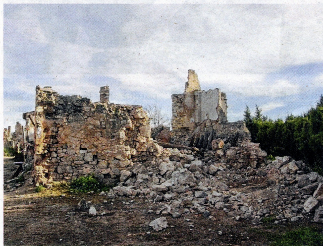
Parets de cases caigudes per la manca d'actuacions i el pas del temps. FOTO: J. REVILLAS
