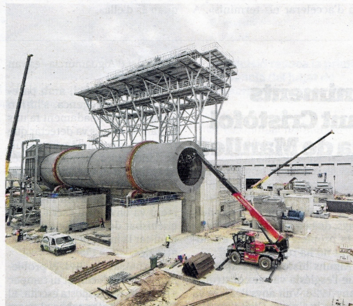
S'ha començat a instal·lar part de la maquinària de la fàbrica. La primera fase del projecte suposa una inversió de 320 milions. FOTO: JOAN REVILLAS
