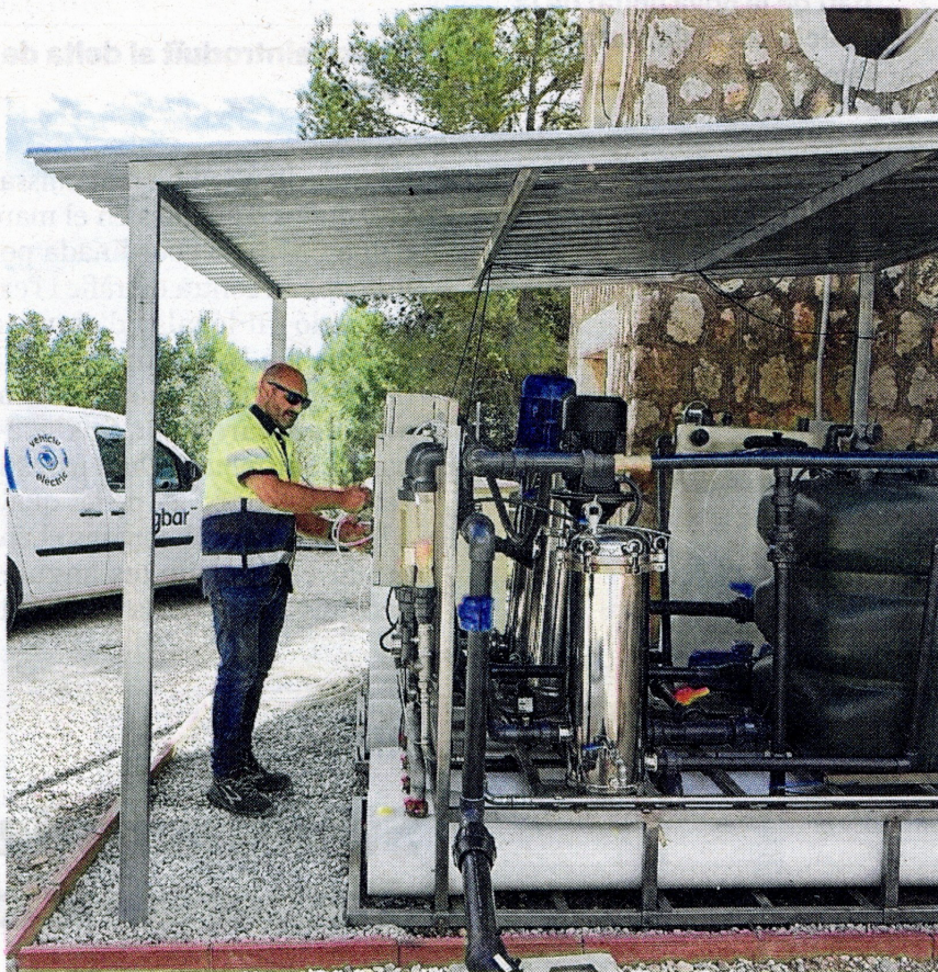
Un tècnic a la planta d'osmosi inversa instal·lada. FOTO: J. REVILLAS
