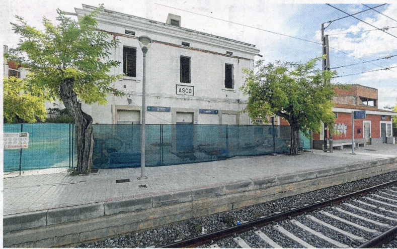
L'estació de tren d'Ascó, actualment en desús, envoltada de la tanca d'obres. FOTO: JOAN REVILLAS
