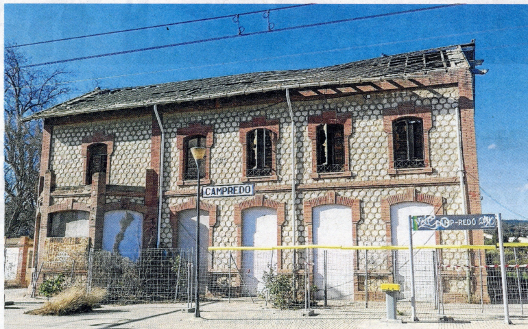
L'estació de Campredó, tancada i amb la teulada afectada. FOTO: JOAN REVILLAS
