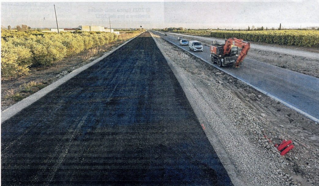
Obres en execució a la carretera N-238, al terme de Vinaròs. FOTO: JOAN REVILLAS
