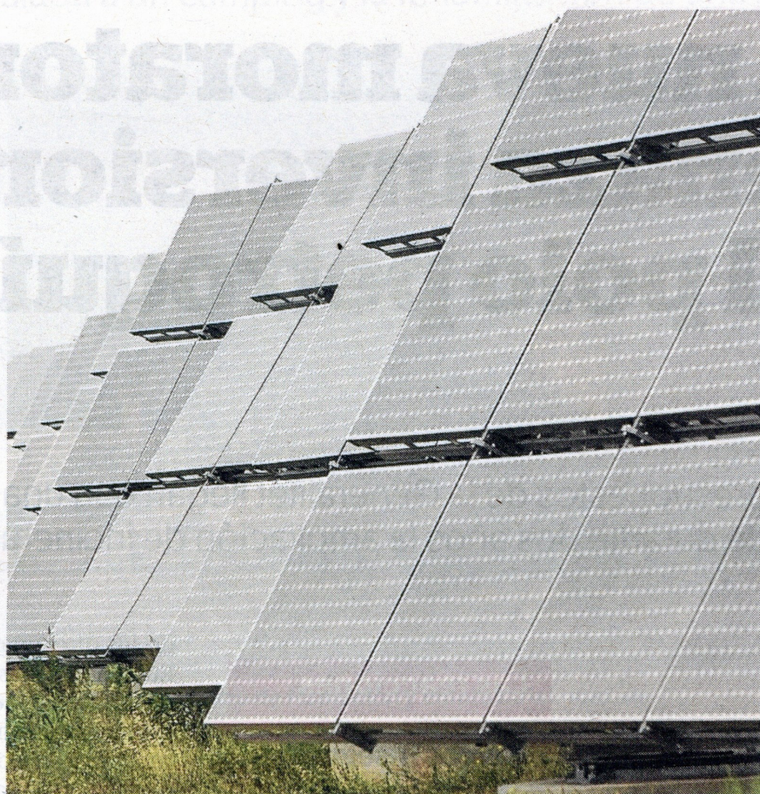
Una planta solar fotovoltaica. FOTO:JOAN REVILLAS
