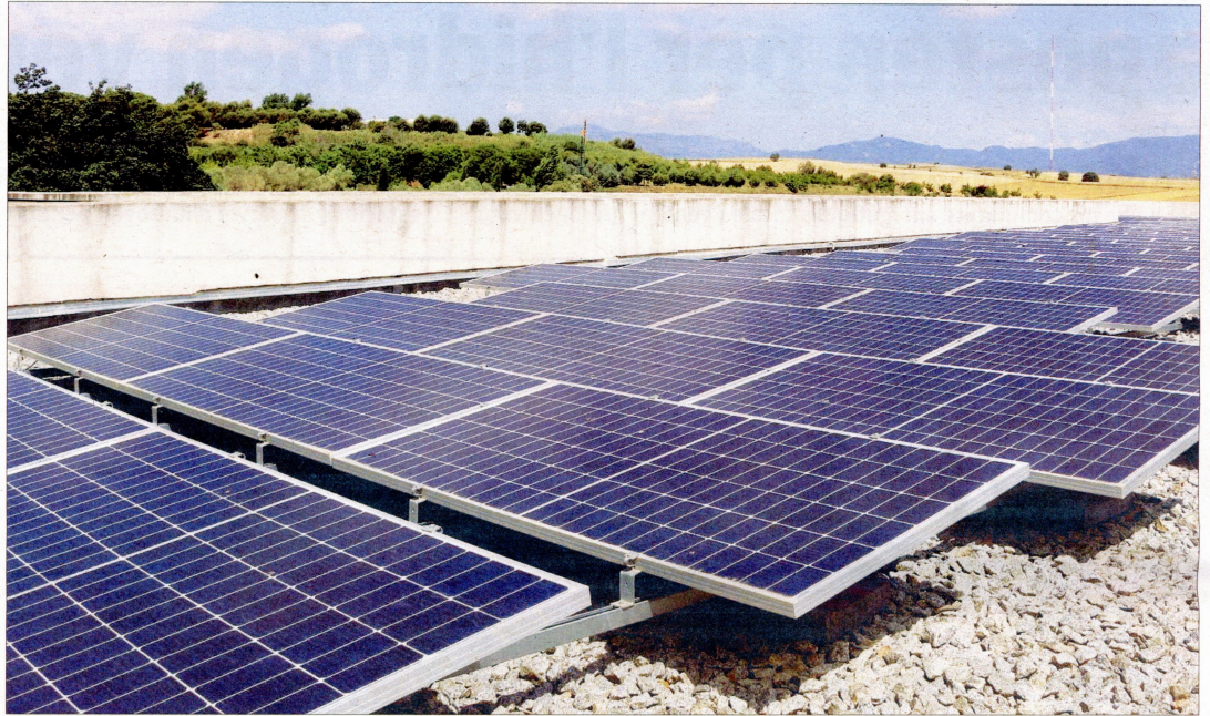
Planta solar a l'Ametlla de Mar. FOTO: LA CALA RTV
