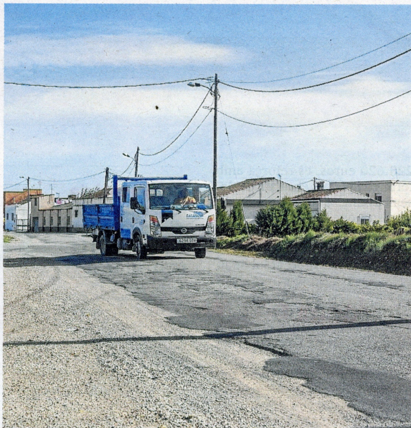
El paviment de l'avinguda de la Pau, molt degradat. FOTO: JOAN REVILLAS
