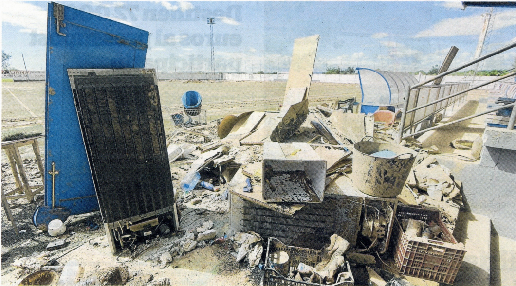
Deixalles acumulades i material fet malbé al camp de futbol la Fanecada d'Alcanar, divendres passat. FOTO: JOAN REVILLAS
