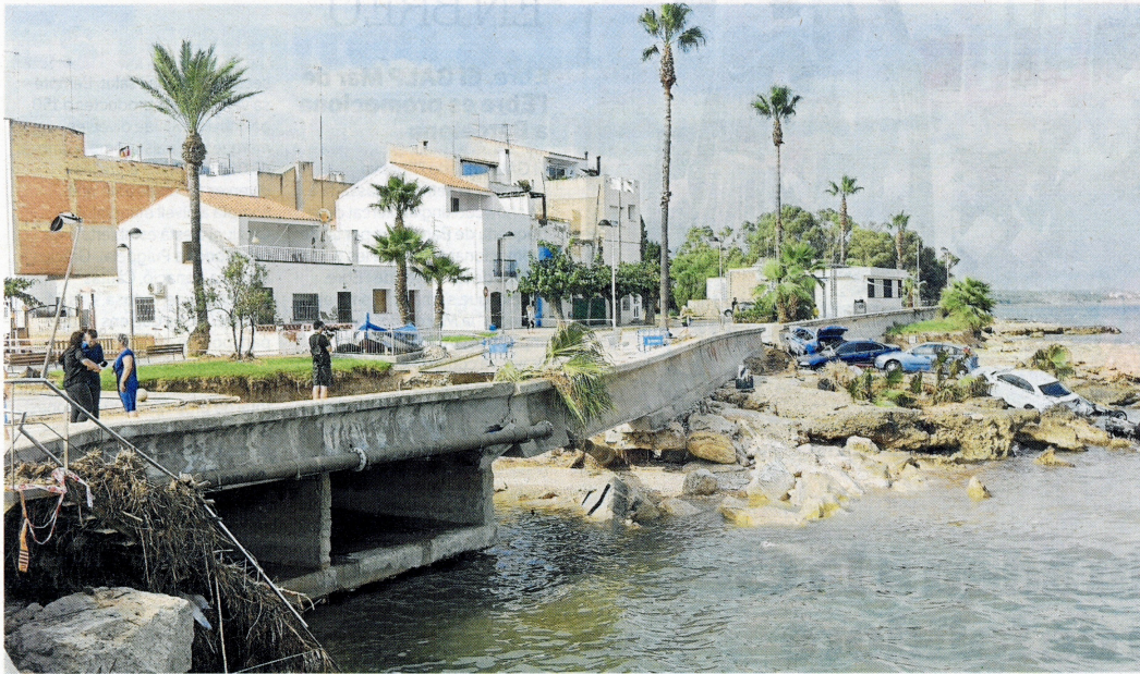
Detall de l'esvoranc obert al nord de la façana marítima des les Cases, on encara hi ha vehicles a la mar, ahir. FOTO: JOAN REVILLAS
