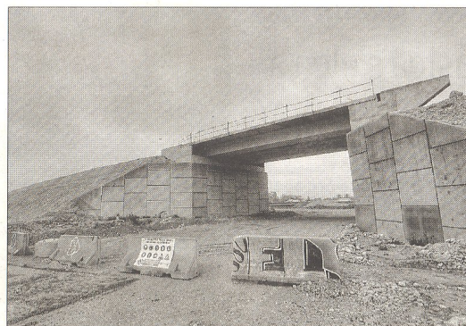
Les obres de la variant de la N-340 al pas per l'Aldea s'estan degradant progressivament a causa de l'abandonament que pateix. FOTO: J. REVILLAS/DIT
