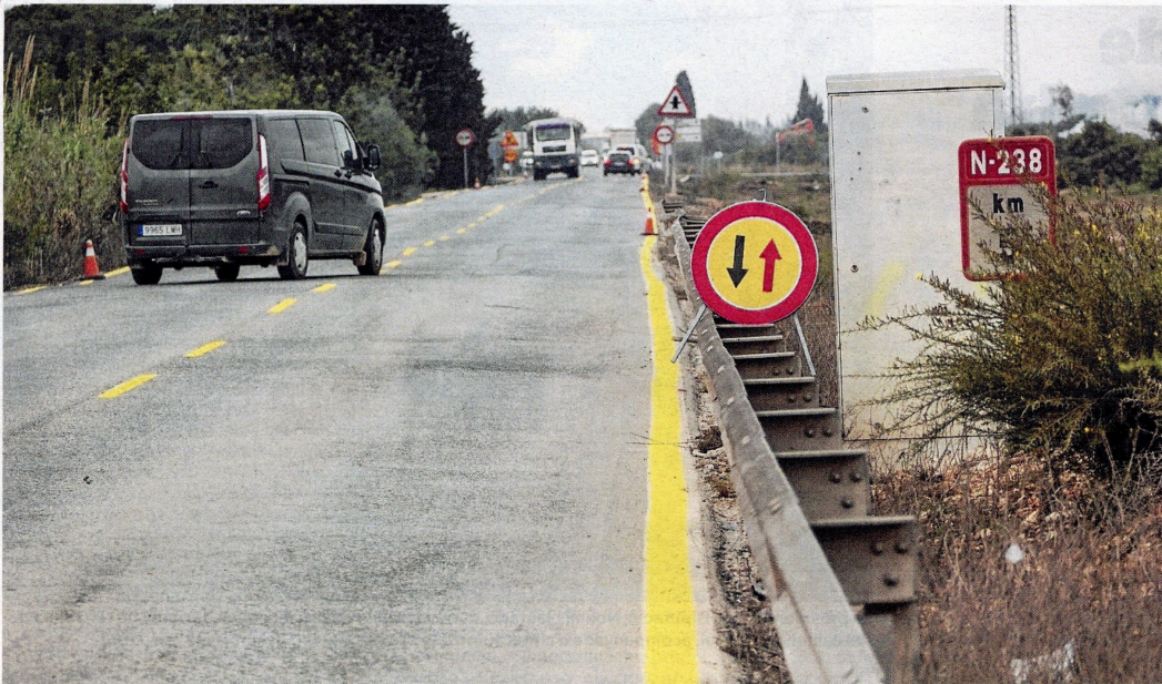
Estat actual de la carretera N-238, al terme municipal de Vinaròs. FOTO: JOAN REVILLAS
