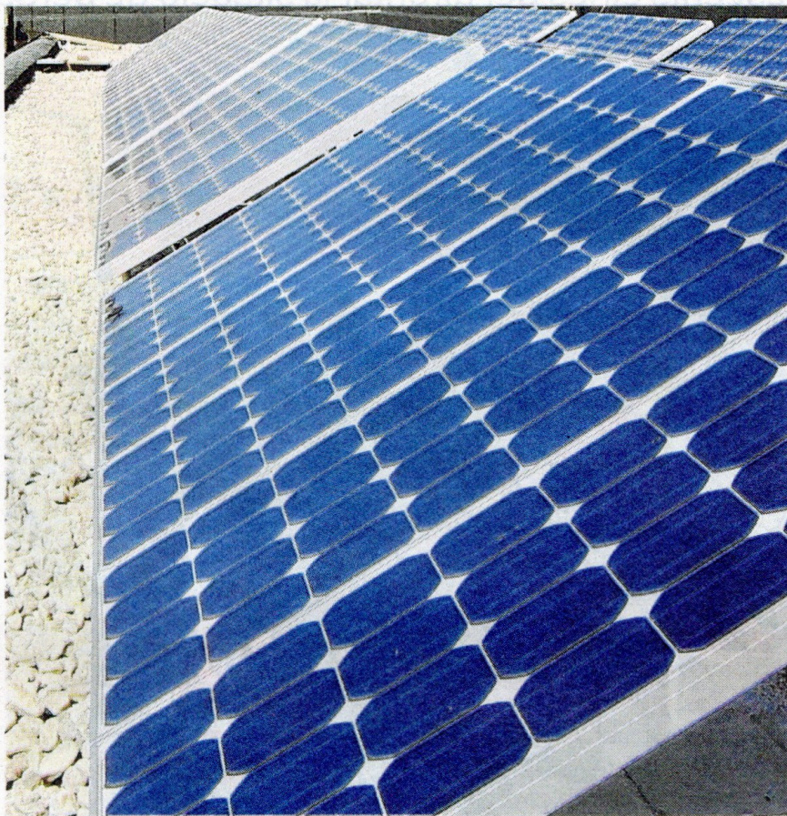
Plaques fotovoltaiques en un sostre. FOTO: JOAN REVILLAS
