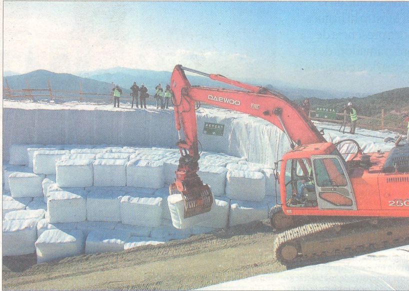
Imatge de la pedrera de la Vallensana, a Badalona, convertida en dipòsit de residus empaquetats. FOTO: DT
