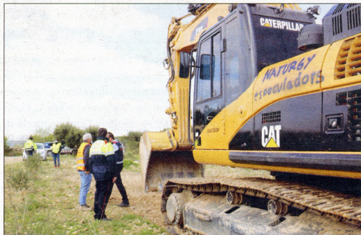
Les màquines comencen a construir el parc eòlic Los Barrancs, a Vilalba.
