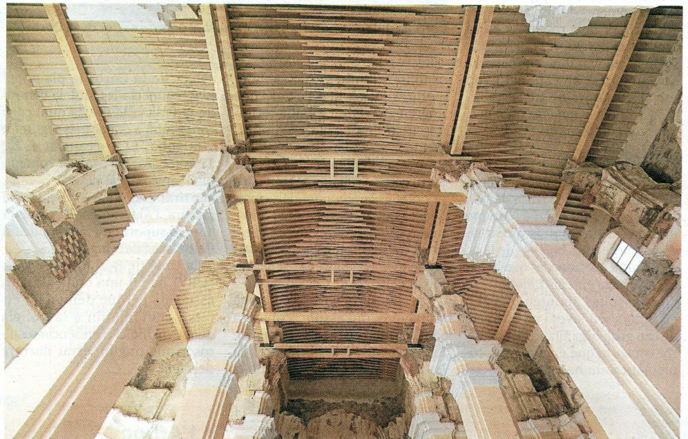
L'interior de les naus, amb la nova estructura de fusta de sustentació de la coberta. FOTO: JOAN REVILLAS
