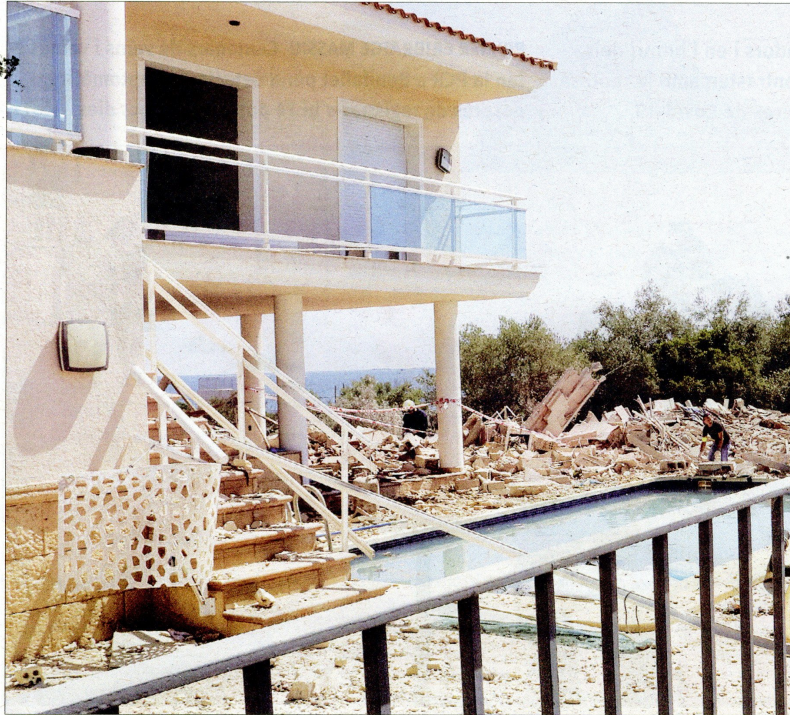
Imatge de la casa esfondrada en l'explosió d'Alcanar Platja. FOTO: ACN
