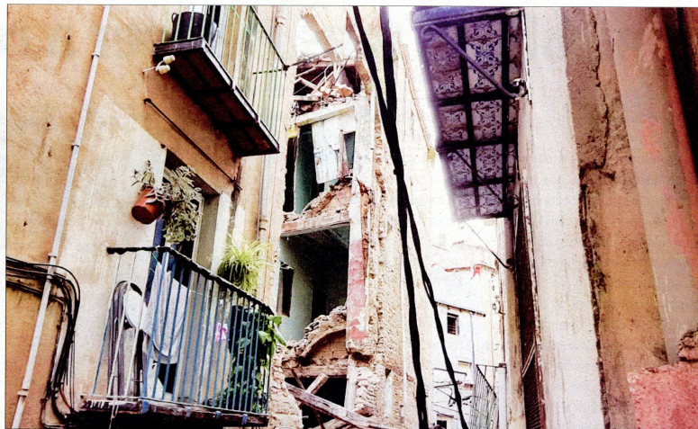
La situació de les edificacions ruïnoses al nucli antic de la ciutat solament es pot resoldre amb operacions quirúrgiques de demolicions. FOTO ARXIU
