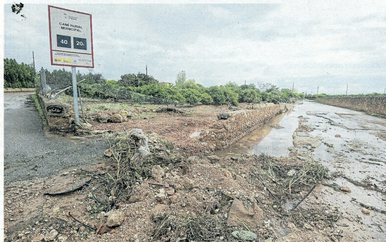
Efectes de la pluja torrencial la tardor del 2018 al terme d'Alcanar. FOTO: JOAN REVILLAS
