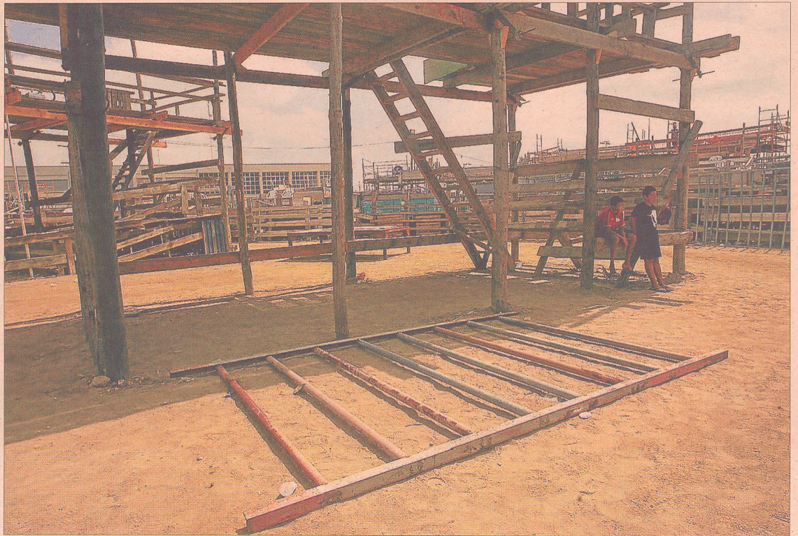
La estructura metálica que cedió por la embestida del bou seguía ayer por la mañana en el suelo para proceder a la investigación
