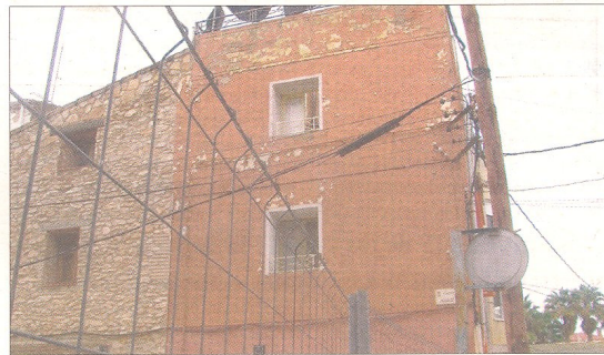
A Amposta es va ensorrar un edifici abandonat del carrer Atúlf. / X. B.
