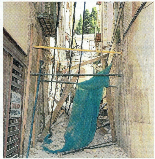
L'habitatge esfondrat aquesta setmana a Santa Clara. FOTO: JOAN REVILLAS
