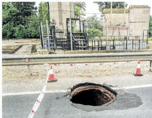
Esvoranc a la carretera, ahir. FOTO: JOAN REVILLAS
