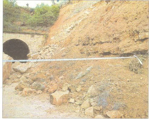
Imatge de l'esllavissada al túnel entre les estacions de Bot i Horta de Sant Joan de l'itinerari de la Via Verda la setmana passada. FOTO: C. C. TERRA ALTA
