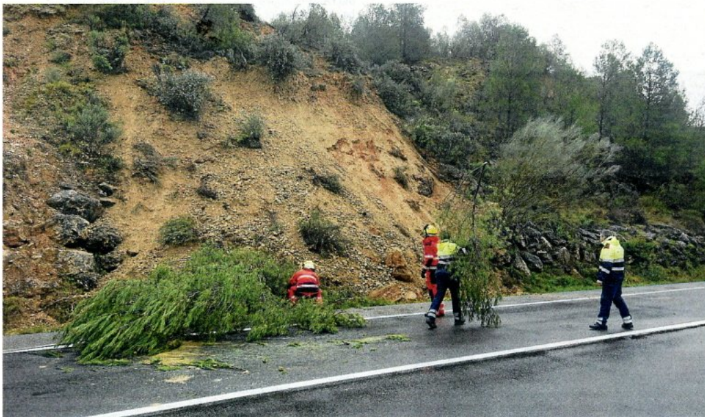
Despreniment a la C-12 a Ginestar, després del temporal Glòria. FOTO: JOAN REVILLAS
