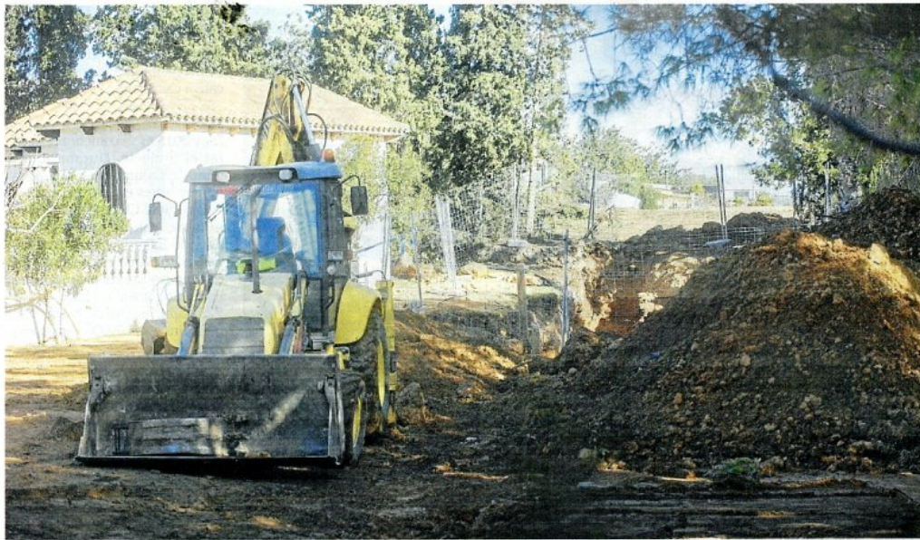
Treballs en la finca on es va produir el trencament de la canonada, ahir. FOTO:JOAN REVILLAS
