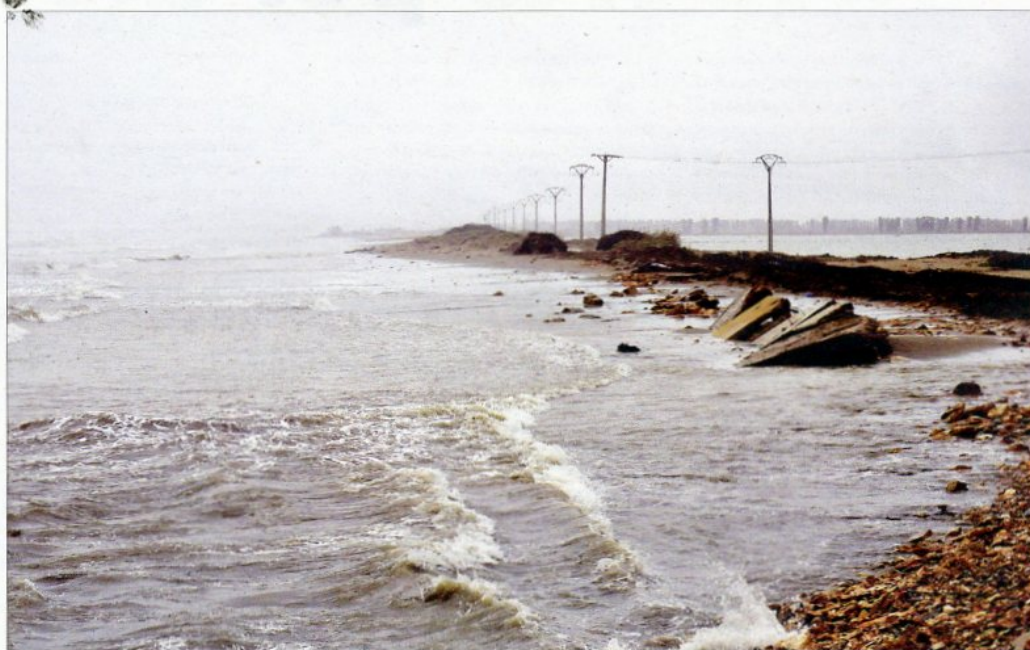
La platja de la Marquesa ha quedat pràcticament esborrada i esta vegada el mar s'ha endut el camí que duia a l'estació de bombament de Pal. FOTO: NÚRIA CARO
