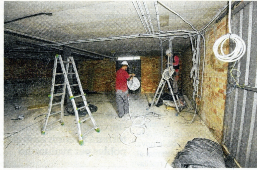
S'estan executant les obres d'adequació de la sala, que permetrà acabar el Centre Cultural del Delta. FOTO: JOAN REVILLAS
