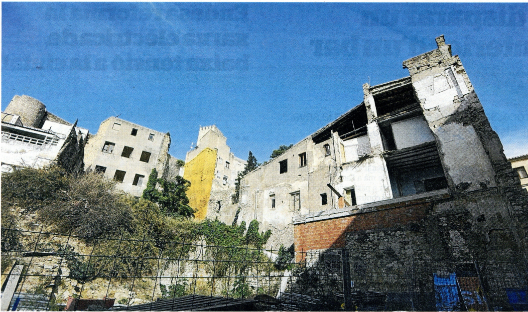
Imatge del carrer Sant Felip Neri, amb diversos habitatges en molt mal estat. FOTO: JOAN REVILLAS
