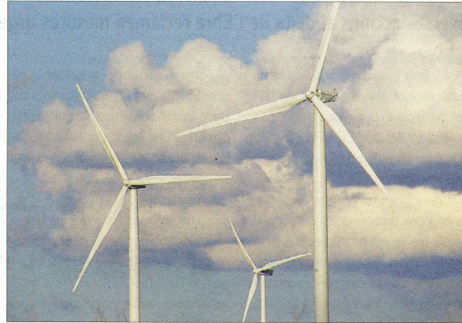
A la Terra Alta hi ha actualment 184 aerogeneradors en funcionament.
