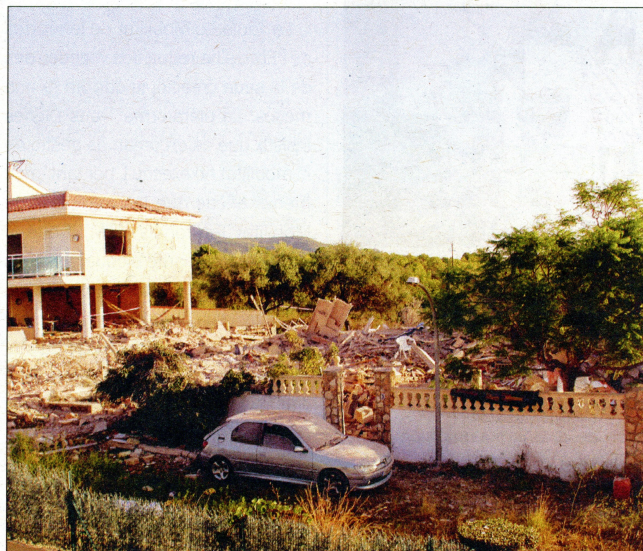
Estat en què va quedar el xalet d'Alcanar després de l'explosió.
