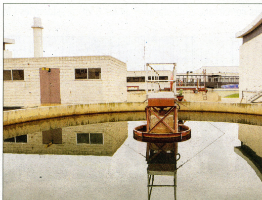
Imatge de les instal·lacions de la planta potabilitzadora del CAT a l'Ampolla.
