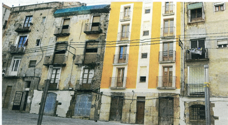
Fotografia d'un grup d'edificis a la plaça Gerard Vergés, plens de cablejat. FOTO: JOAN REVILLAS
