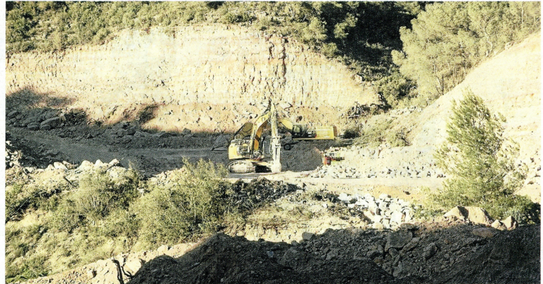
Imatge dels treballs als terrenys on es construirà el dipòsit de residus de Riba-roja. FOTO: JOAN REVILLAS
