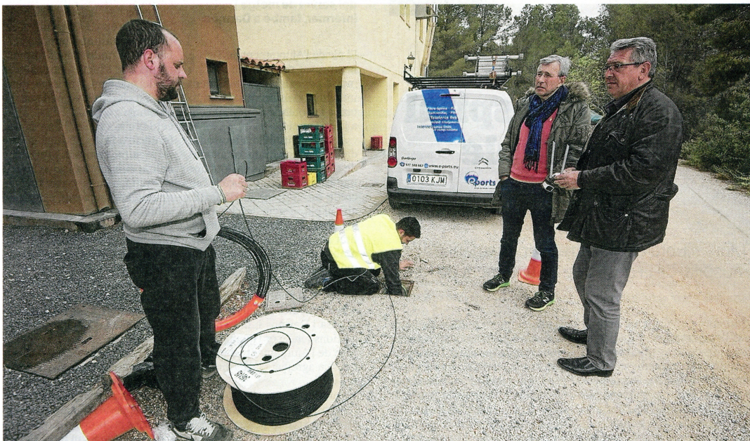
Els operaris treballant ahir a l'antiga estació de Benifallet, a la Via Verda. FOTO: JOAN REVILLAS
