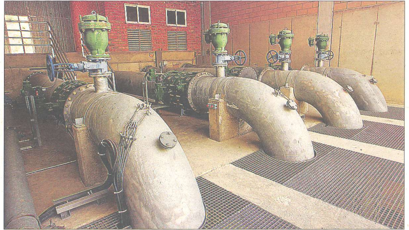
Instal·lacions de la Comunitat de Regants de la Terra Alta. / REGZOTA.COM
